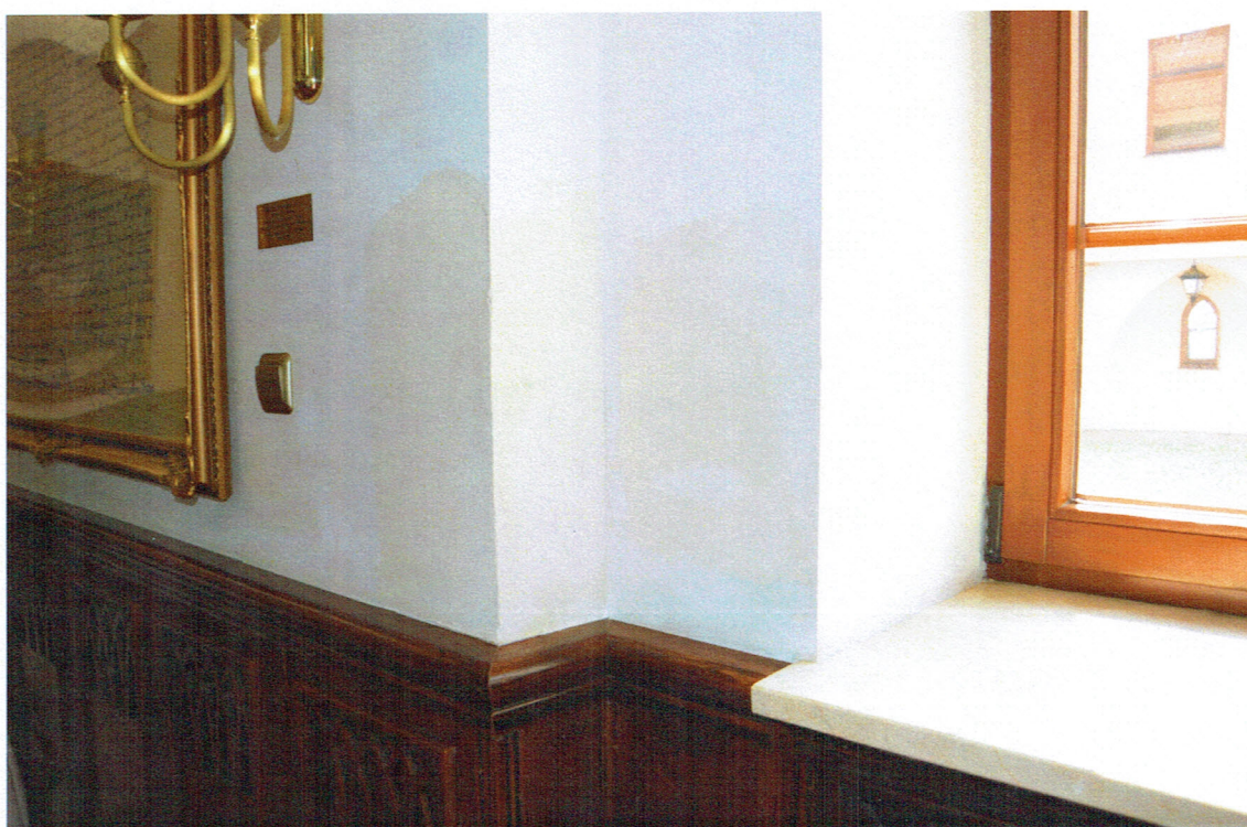
Fot. 9. Ślady napraw tynku nad okładziną drewnianą
