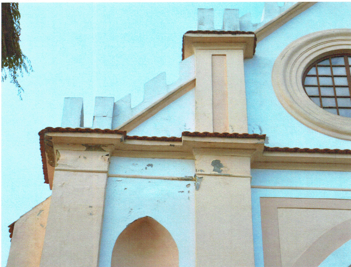
Fot. 20. Fragment elewacji wschodniej – widoczne ubytki i odspojenia tynku
