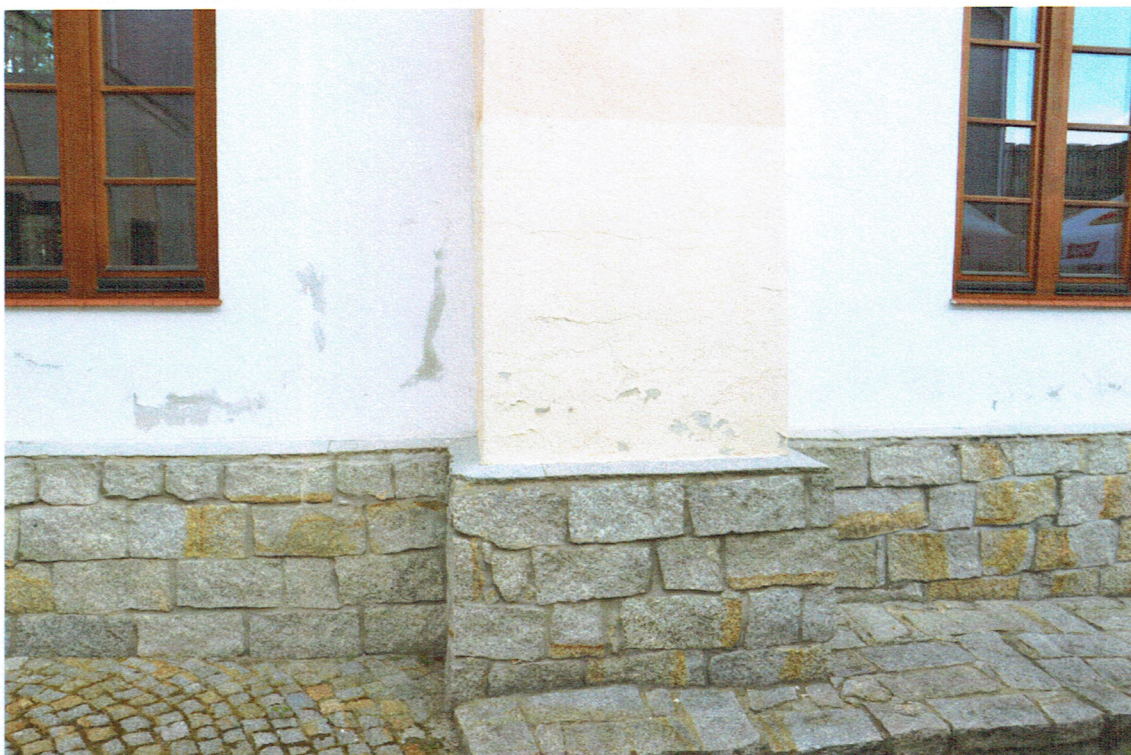
Fot. 16 Ściana południowa budynku – widoczne zarysowania tynku i ubytki powłok malarskich
