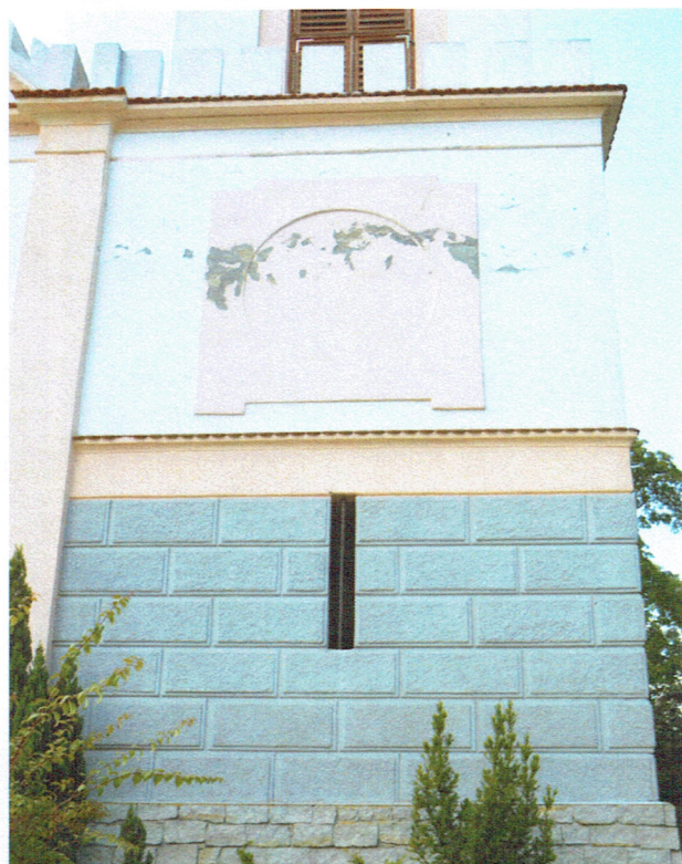
Fot. 26. Wieża od strony wschodniej – widoczne ubytki powłok malarskich
