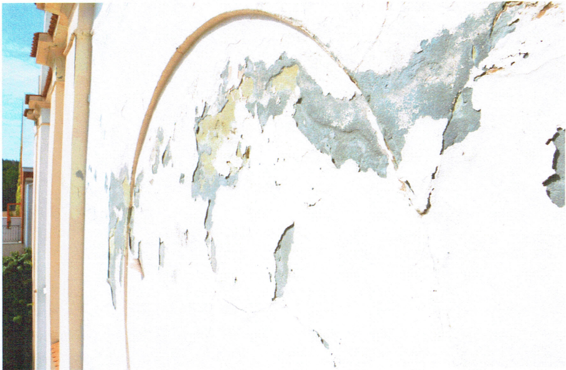
Fot. 77. Odspojenia szpachli cementowej i powłok malarskich na wschodniej ścianie wieży, w miejscu dawnego zawilgocenia
