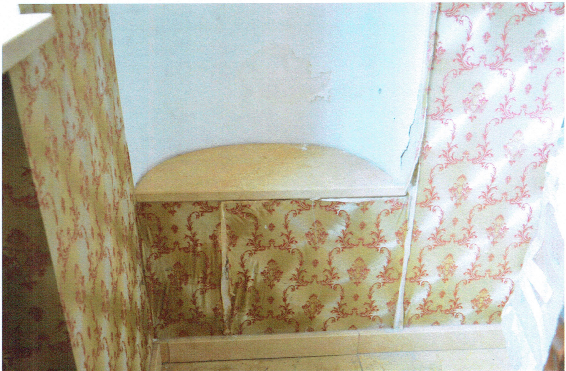
Fot. 12. Ślady zasolenia tynku i muru – widoczne odspojenie tapet i powłok malarskich
