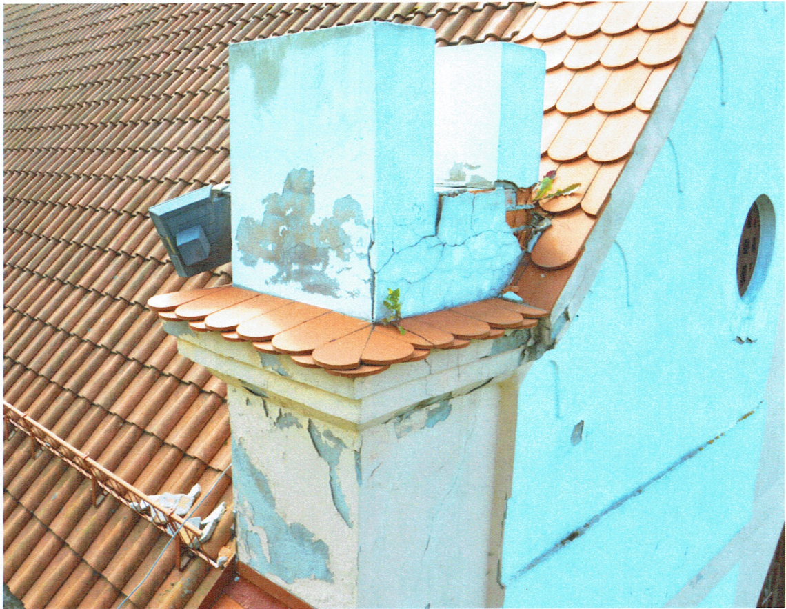
Fot. 72. Zniszczenia tynku, powłok malarskich i powierzchni muru attyki zachodniej
