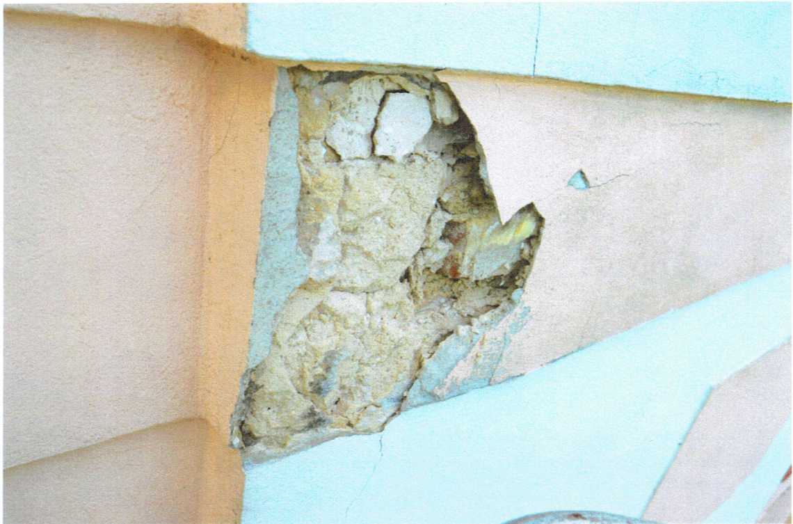
Fot. 61. Fragment elewacji zachodniej - widoczne odspojenie tynku i spękanie starego tynku
