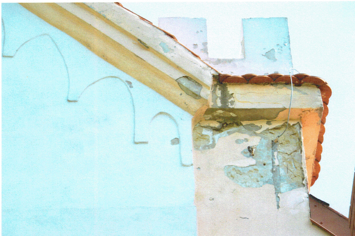
Fot. 41. Fragment elewacji zachodniej – widoczne ubytki i tynku i powłok malarskich
