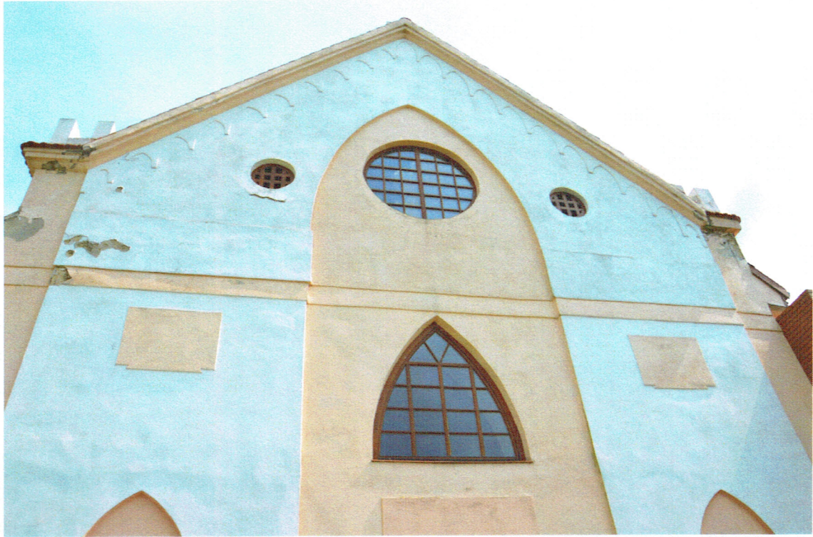
Fot. 52. Fragment elewacji zachodniej – widoczne ubytki tynku, powłok malarskich i nierówności.
