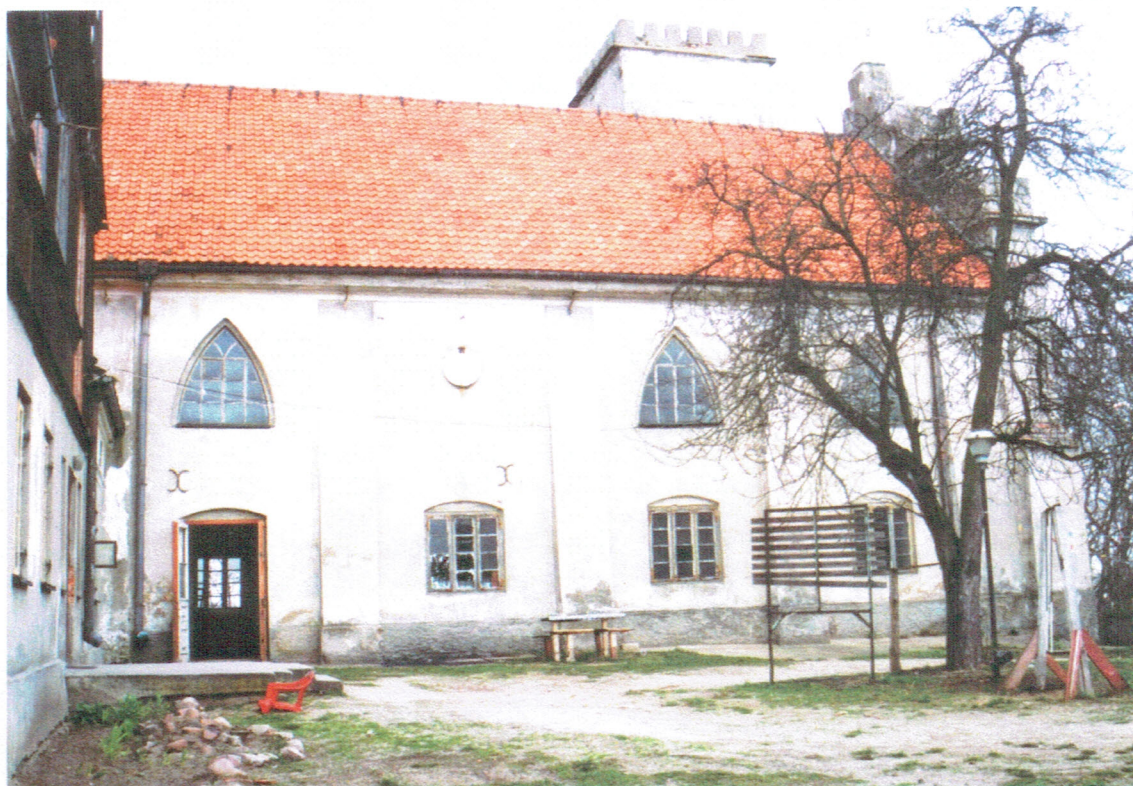
Fot. 96. Elewacja południowa przed remontem – widoczny poziom zwilgocenia i zasolenia ścian
