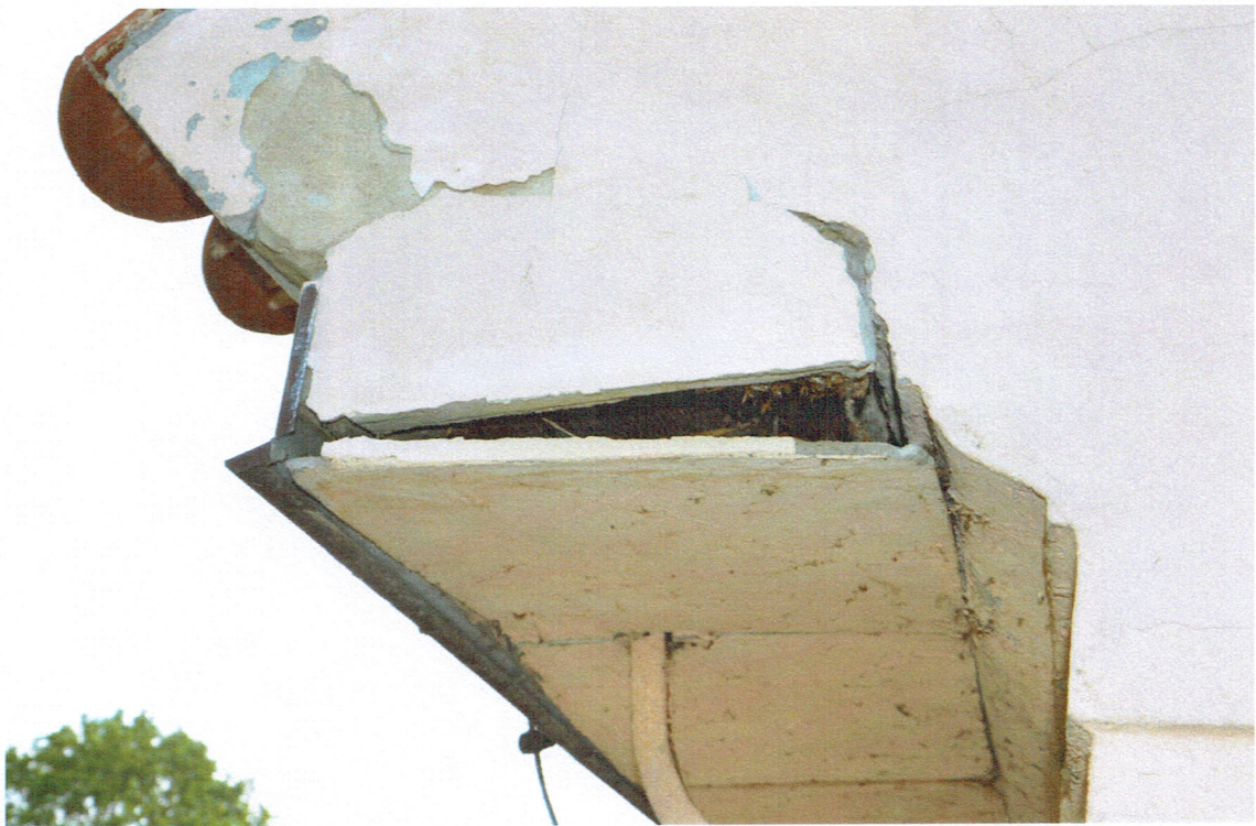
Fot. 54. Fragment elewacji zachodniej - widoczne odspojenie poluzowanie okładzin gzymsu i korozja biologiczna deski stelaża
