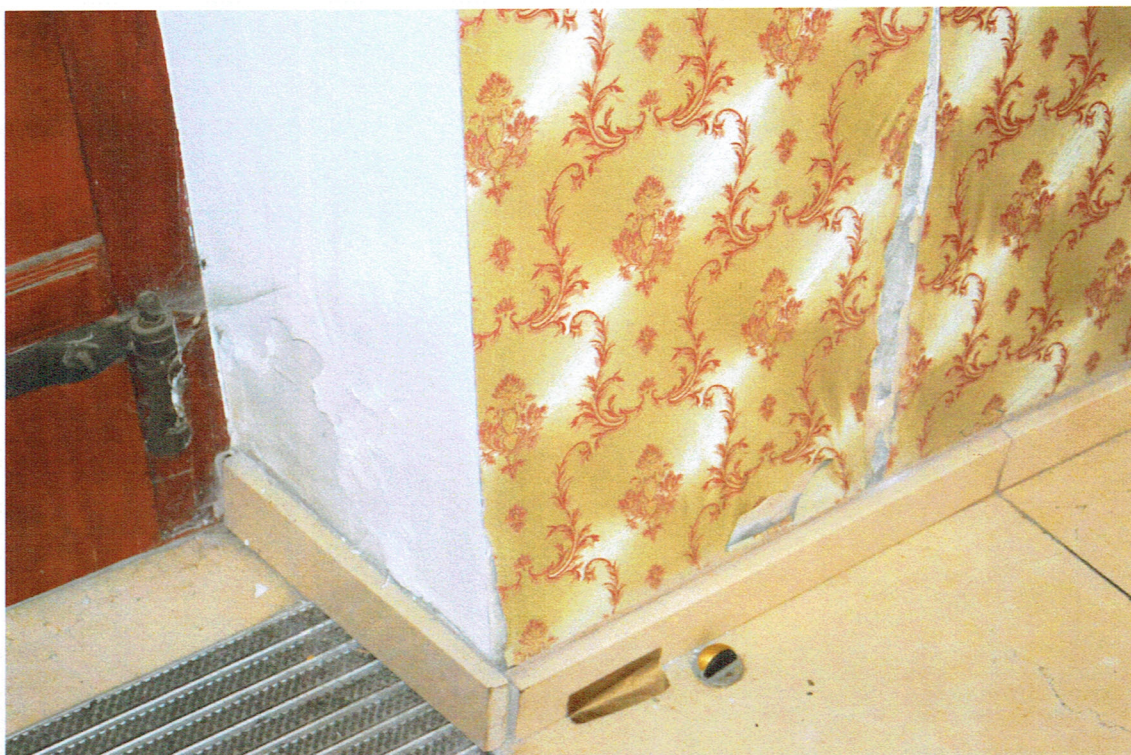
Fot. 6. Fragment ściany wschodniej przy drzwiach wejściowych – widoczne złuszczenie farby oraz zasolenie tynku w styku tapet
