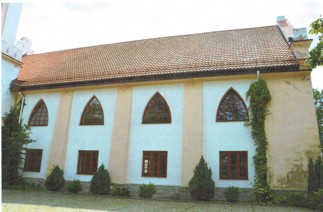
Fot. 50. Elewacja północna – widoczne mchy na przyporach
