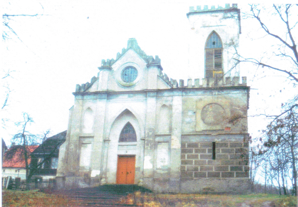
Fot. 97. Elewacja wschodnia przed remontem – widoczny obszary zwilgocenia i zasoleni ścian
