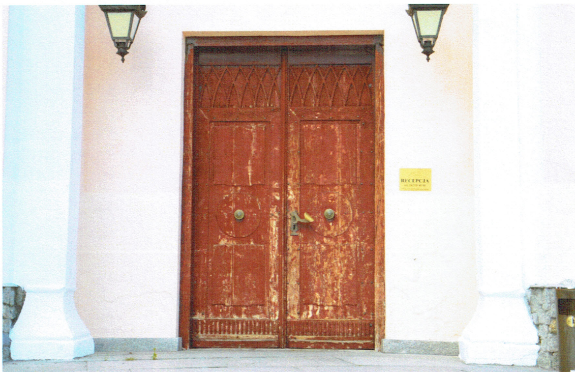
Fot. 22. Zabytkowe drzwi frontowe – widoczne ubytki powłok malarskich
