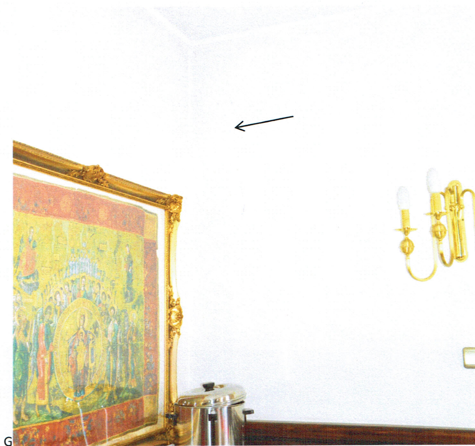
Fot. 10. Zarysowanie ściany na styku z wieżą
