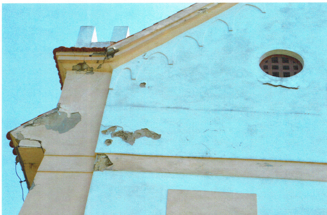
Fot. 36. Fragment elewacji zachodniej – widoczne ubytki i tynku i powłok malarskich
